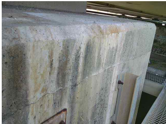
P8 코핑부 균열(폭 0.2mm)
