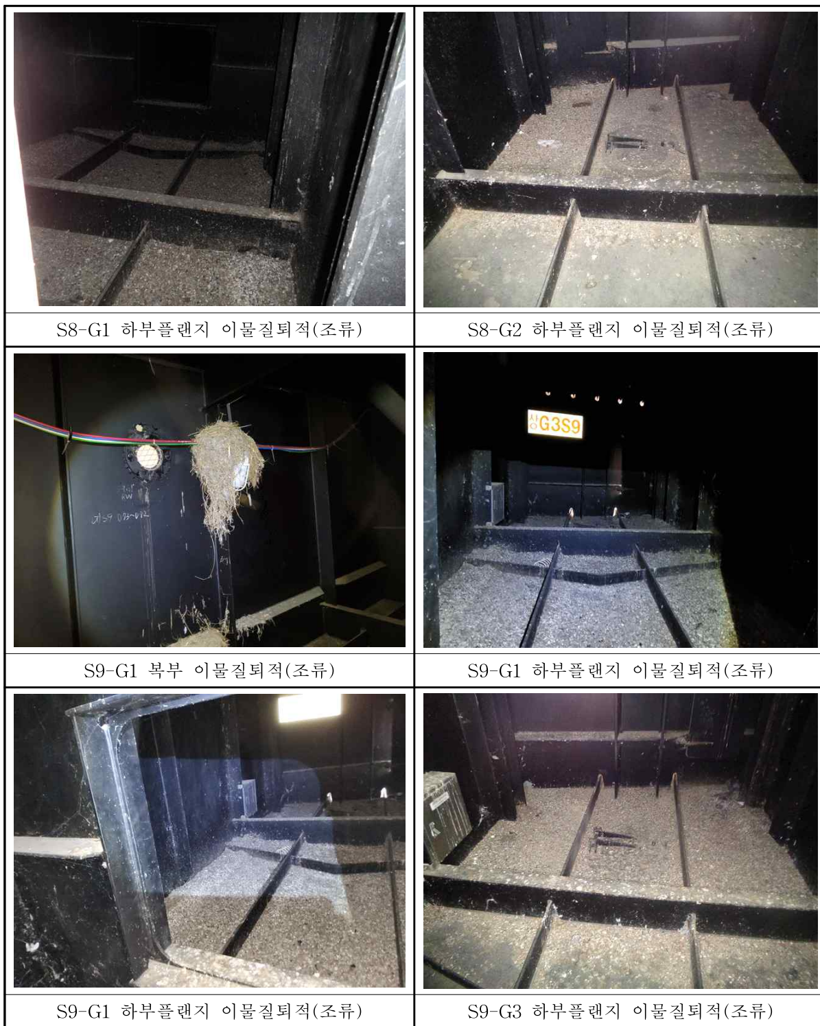
<표 3.3> 범물방향 거더 내부 외관조사 결과
