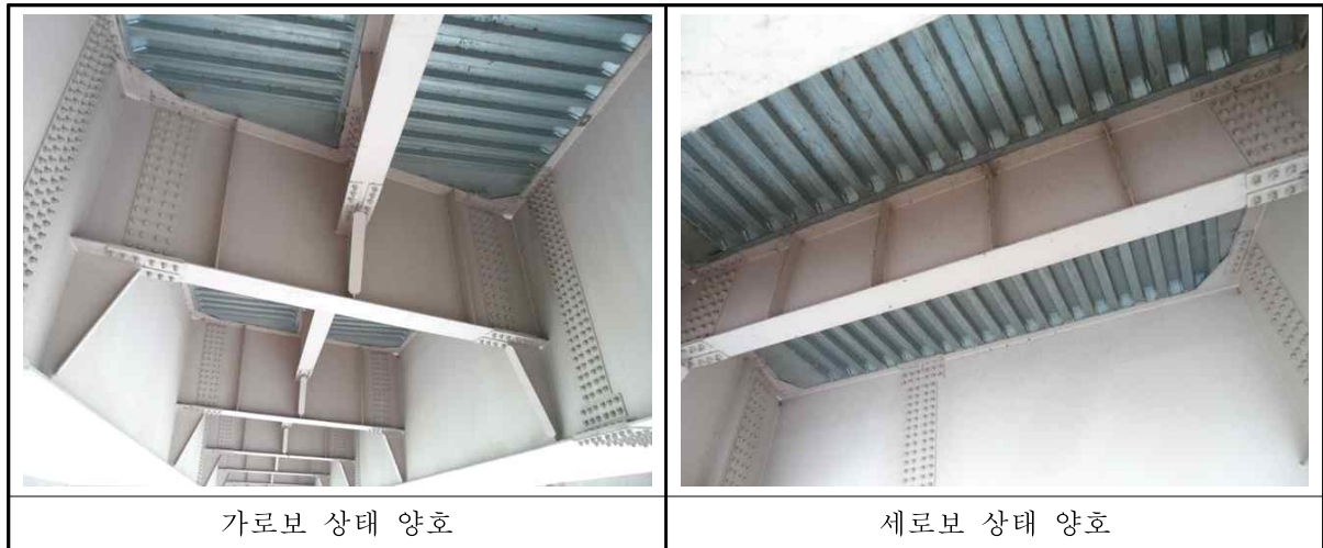
<표 3.6> 범물방향 가로보 외관조사 결과
