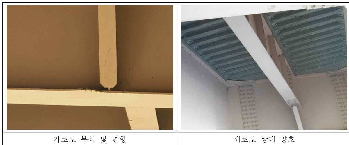
<표 3.36> 안심방향 가로보 외관조사 결과
