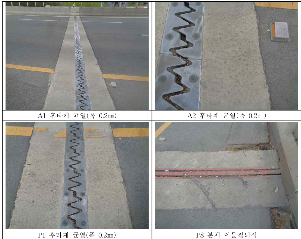
<표 3.17> 범물방향 신축이음 외관조사 결과
