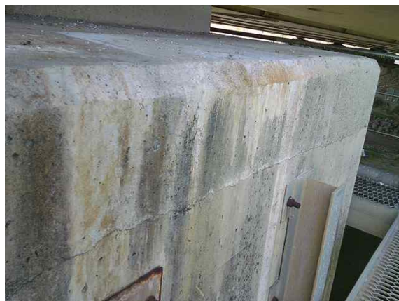
P8 코핑부 균열(폭 0.2mm)
